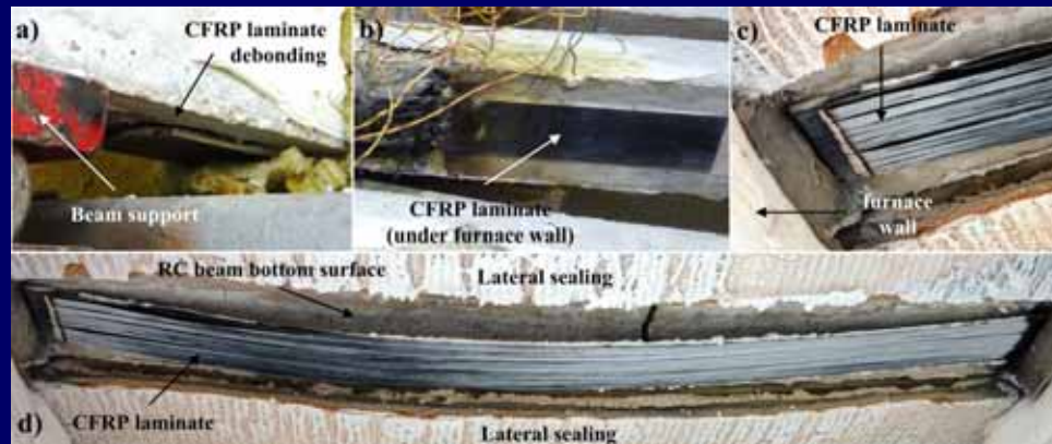
Rotura da viga CFRP
